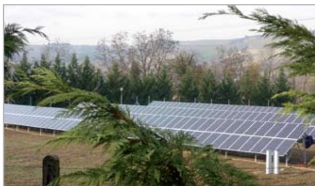
Faenza (RA) - Impianto Fotovoltaico a terra
