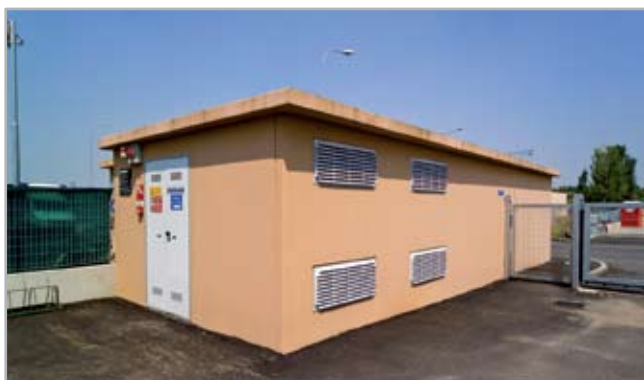
Modena - Cabina Elettrica MT/BT
