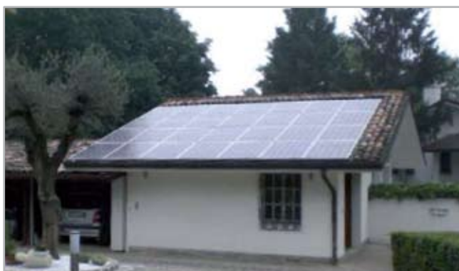
Fiorano Modenese (MO) - Impianto Fotovoltaico
